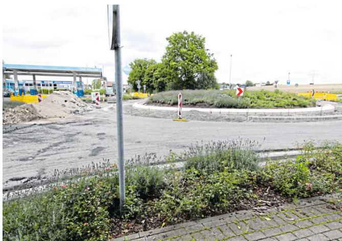
Am Kreisel an der Eilshäuser Kirche sind noch einige Arbeiten zu erledigen. Foto: Björn Kenter
